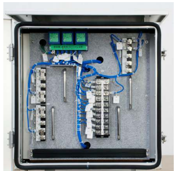
外線接続側実装写真
