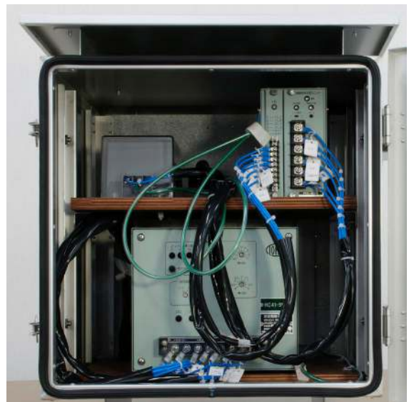
機器収納側実装写真
