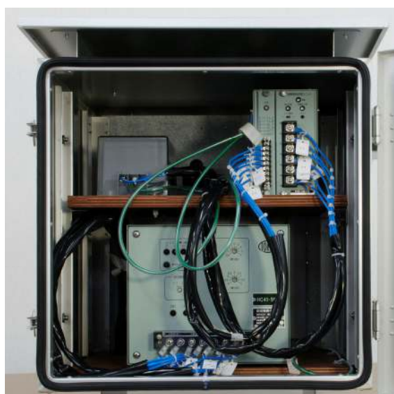
機器収納側実装写真
