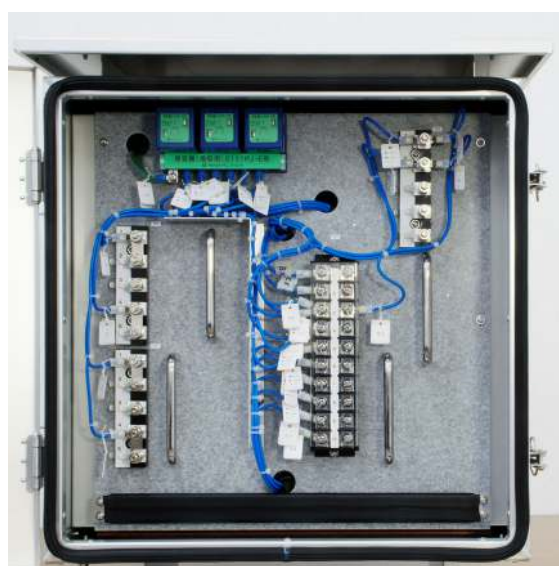
外線接続側実装写真
